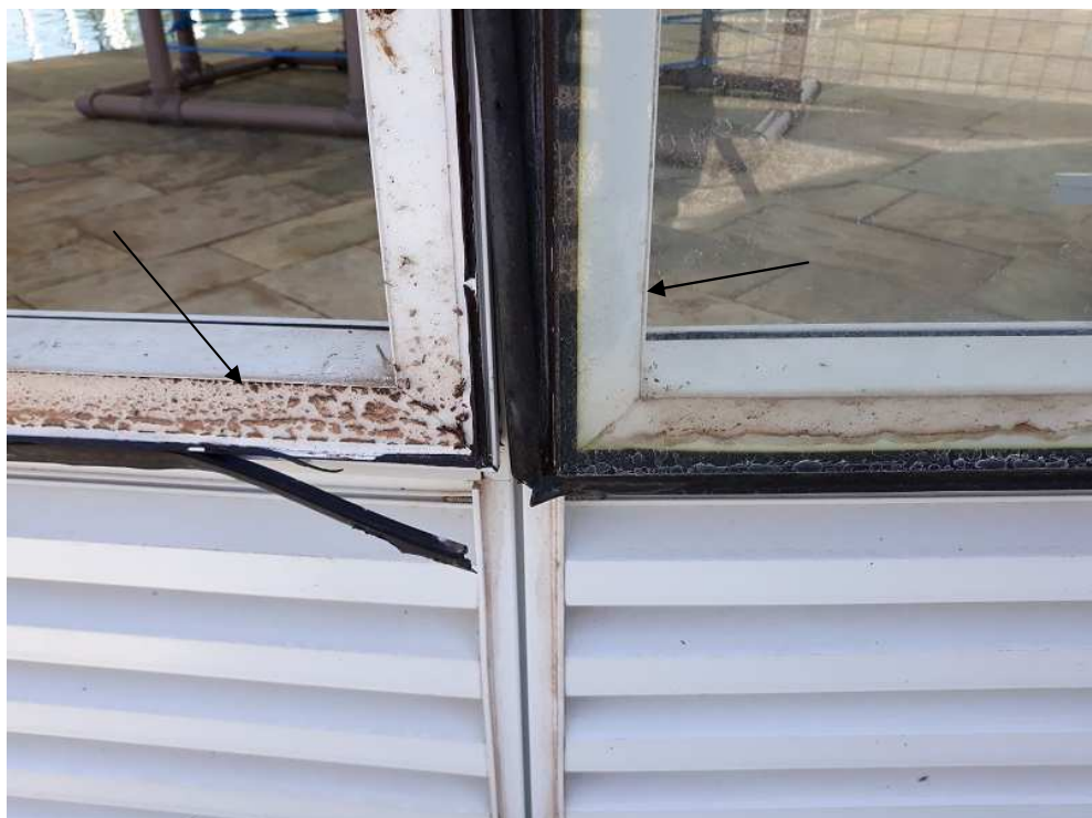
Foto 12 – Praticamente em toda a volta da construção os vidros estão com a colagem e as juntas de borracha em mau estado
