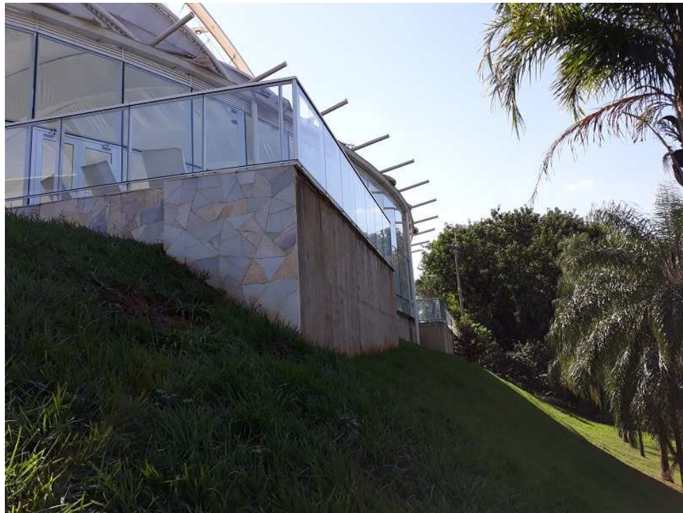
Foto 17 – Vendo pelo lado de fora, o muro de arrimo que foi feito para sustentar o aterro parece intacto.
