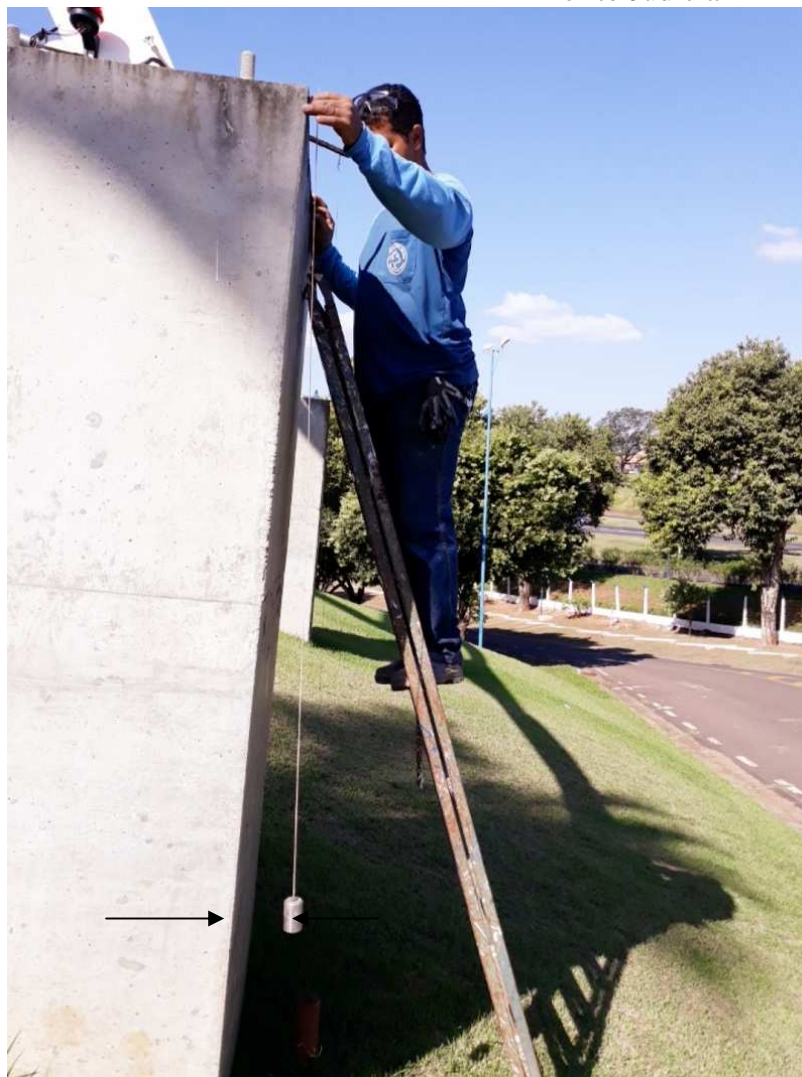
Foto 20 – A primeira pilastra está 11 cm fora de prumo.
