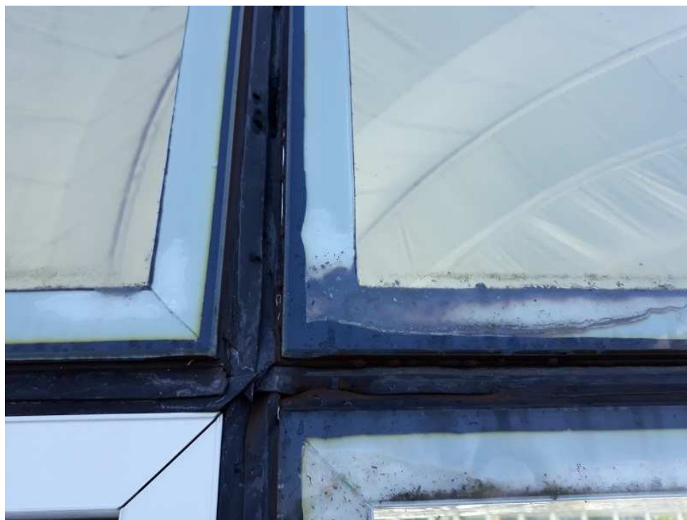
Foto 10 – Vista da precária situação da colagem dos vidros nos caixilhos de alumínio.
