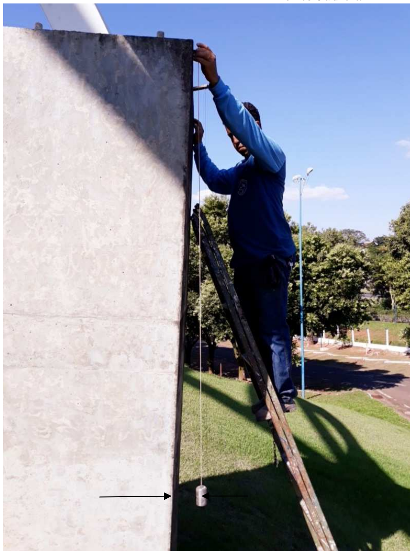
Foto 21 – A segunda pilastra também está 11 cm fora de prumo.
