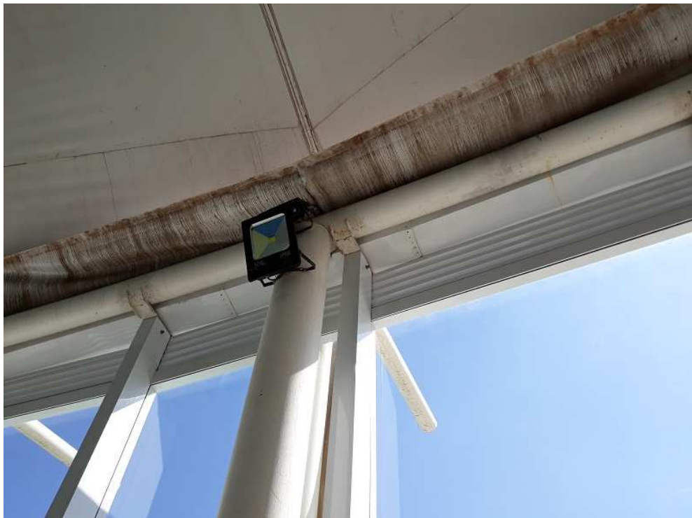
Foto 3 – A “tira” da a volta em toda a cobertura, e está totalmente manchada pela infiltração, com péssima aparência.
