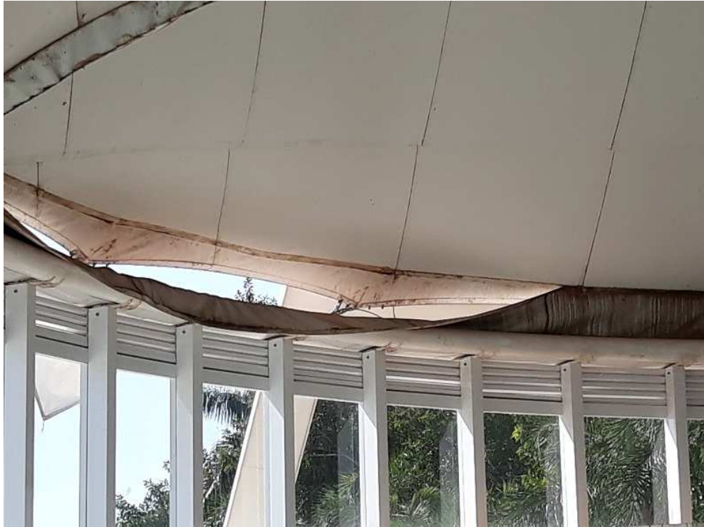
Foto 4- A “Tira” está soltando da lona, e aí pode-se ver que a cobertura ficou curta, não encaixou na estrutura, e então colocaram a tira para completar o fechamento.
