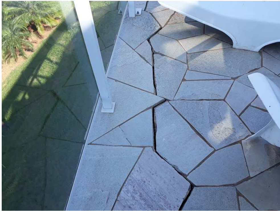
Foto 14 – Na varanda externa, o piso tem uma rachadura provocada pelo solapamento do aterro que o sustenta.
