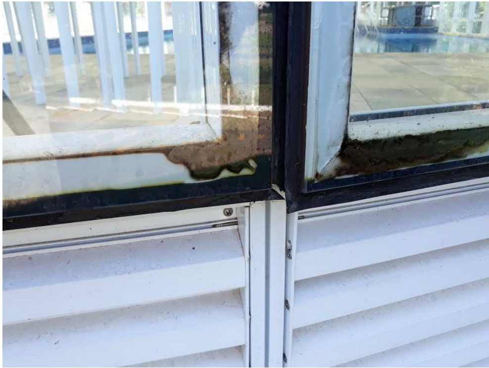
Foto 12 – Outra vista da situação da colagem dos vidros.
