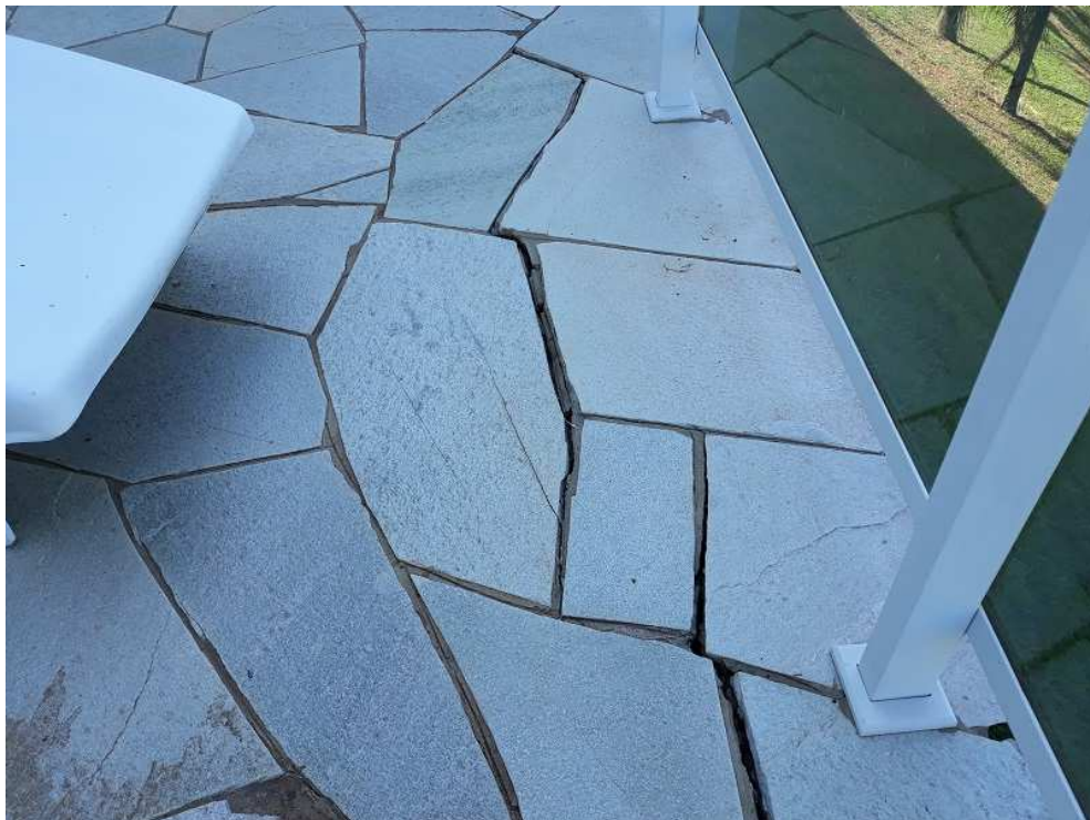
Foto 15 – A rachadura no piso segue por todo o comprimento do muro de arrimo.
