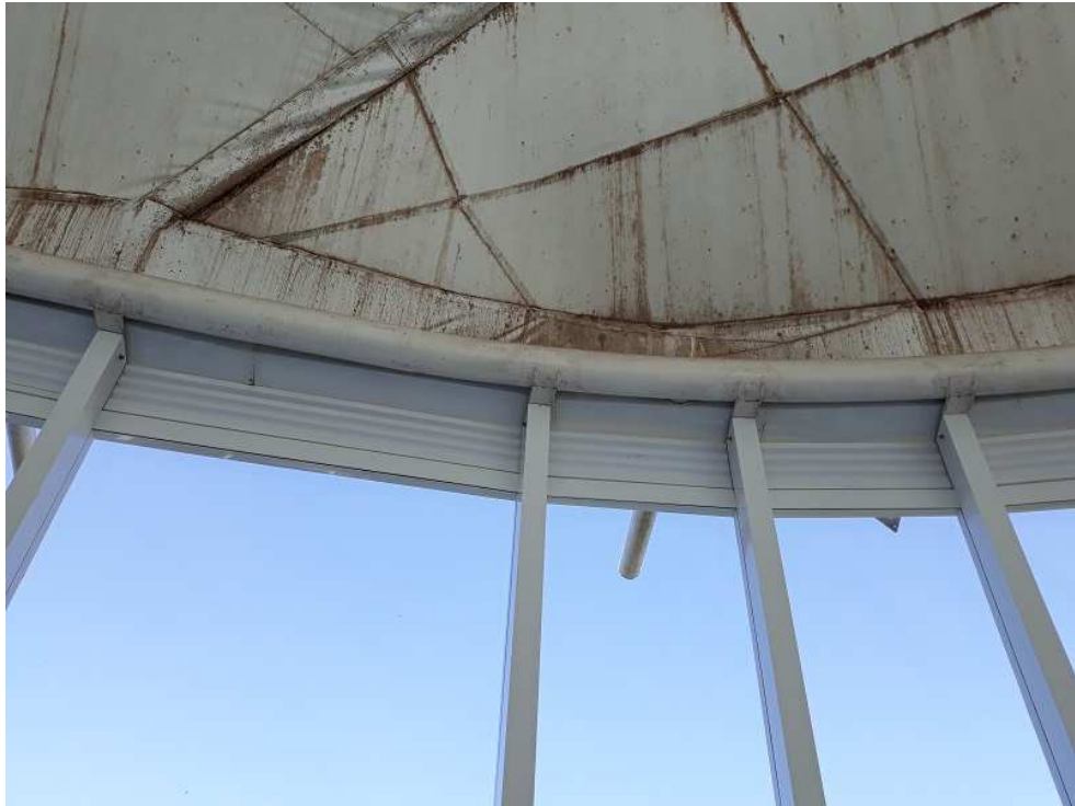
Foto 2 – Por dentro, a lona da cobertura está toda infiltrada e manchada, e existe uma “tira” de lona completando o fechamento.
