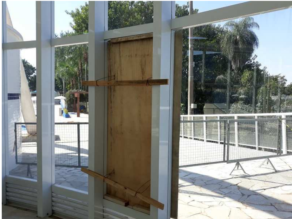
Foto 11 – Um dos vidros caiu, e a piscina foi interditada.
