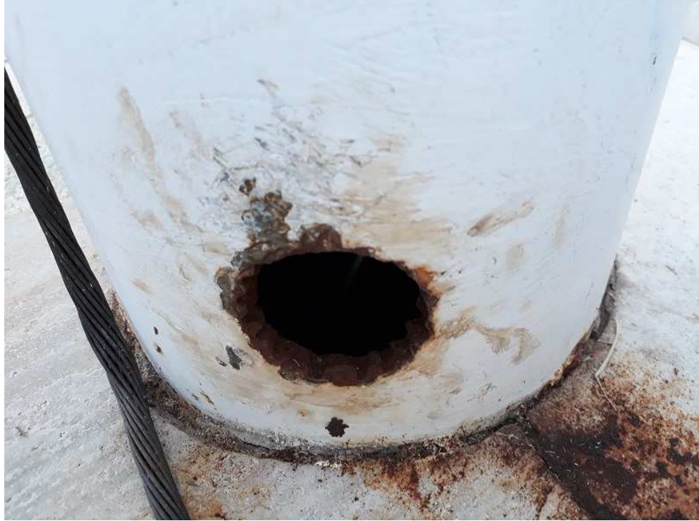
Foto 8 – Em detalhe, o ferro da estrutura está enferrujando por dentro.
